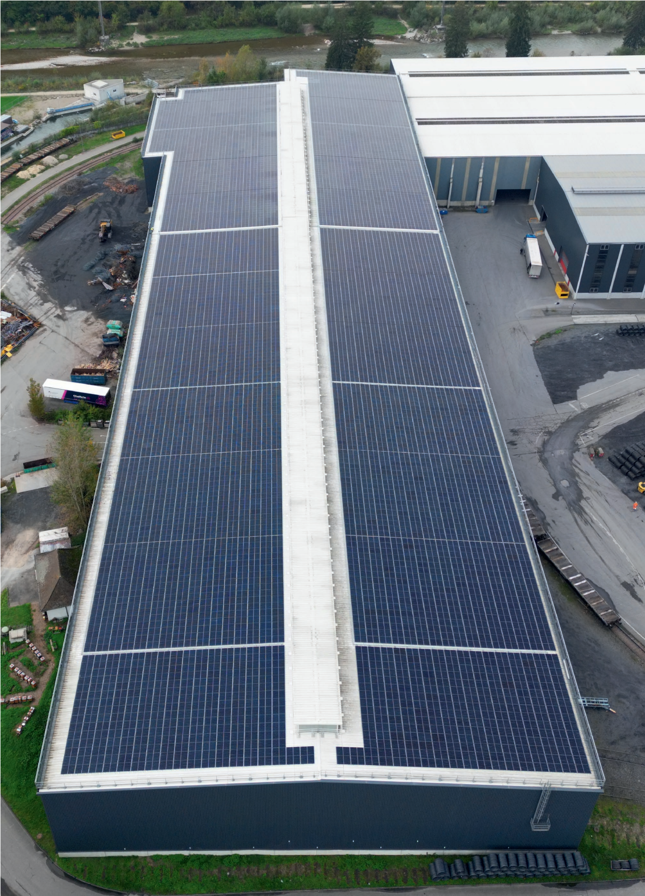
Stahlwerk Gerlafingen mit Photovoltaikanlage der AEW (2,8 MWp)
